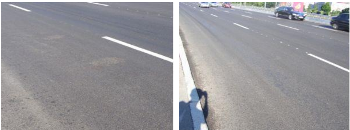
Рисунок А.27 – Стан ЩМА на проспекті Бажана в м. Києві біля ст. метро «Харківська», дальність транспортування складає приблизно 68 км
