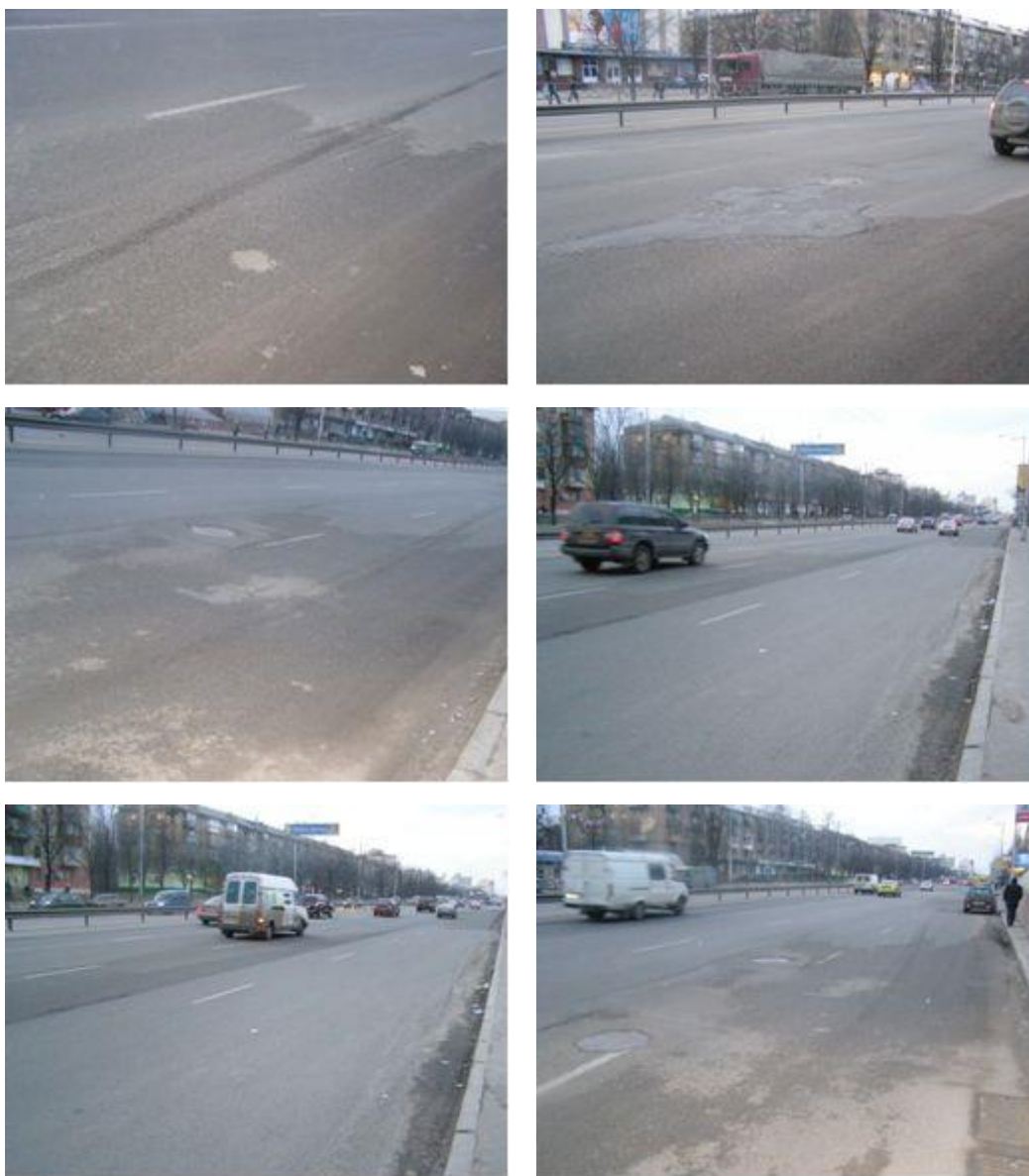
Рисунок А.2 – Неоднорідність асфальтобетонного покриття
