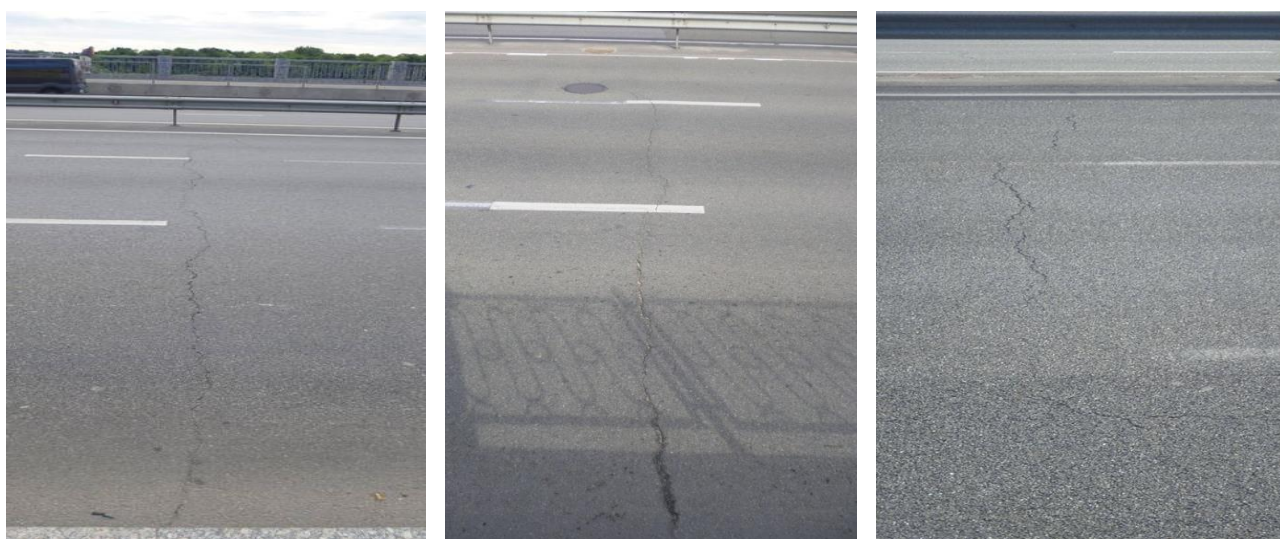
Рисунок А.5 – Руйнування покриття асфальтобетонного покриття на вул. Набережно-Рибальській, м. Київ
