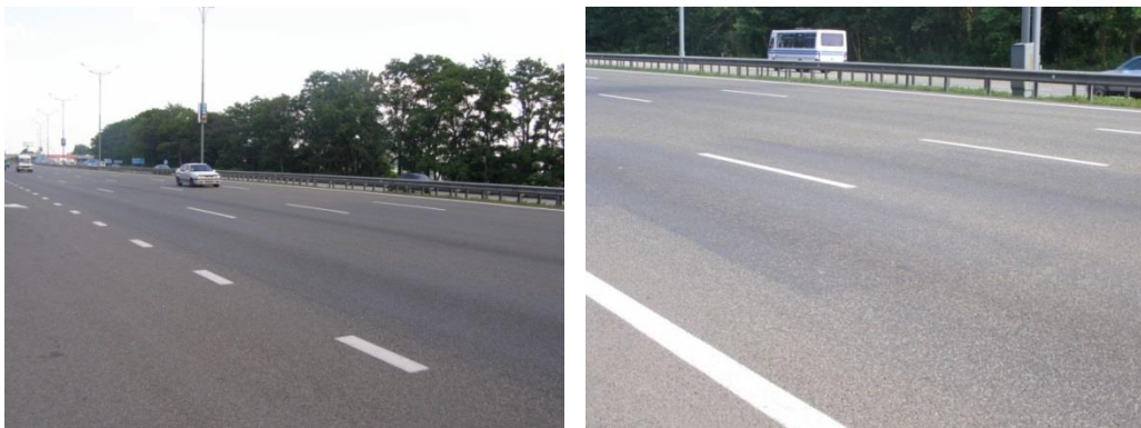
Рисунок А.22– Стан покриття із щебенево-мастикового асфальтобетону автомобільної дороги Київ – Бориспіль (у 2012 р.)
