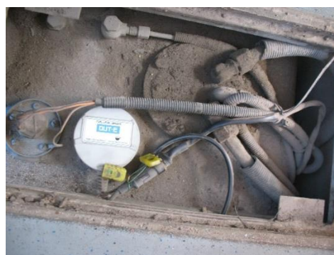
Рис. 2. Місце встановлення датчика в паливному баку автобуса
