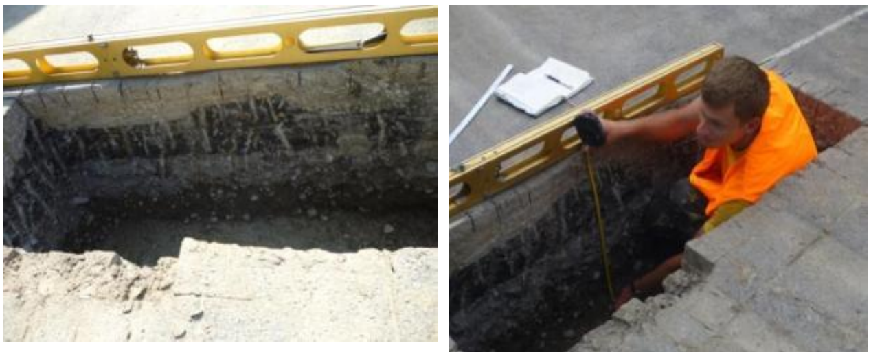
Рисунок 3.56 – Вид розритої конструкції, на секції 3
