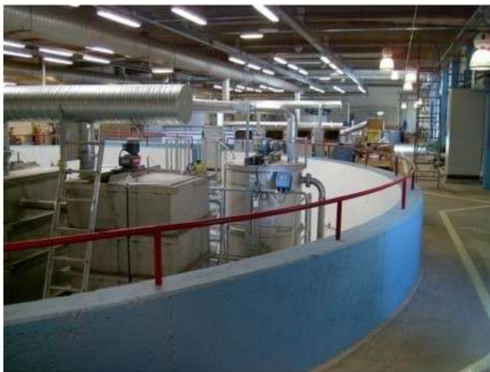
Рисунок 2.17 – Обладнання для фільтрації
