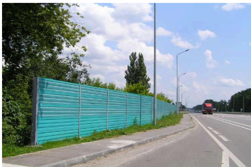
Рисунок 3.12 – Не повністю захищений об'єкт (житлова хата) шумозахисним екраном при реальній можливості здійснити цей захист (217 км, Київська обл.)
