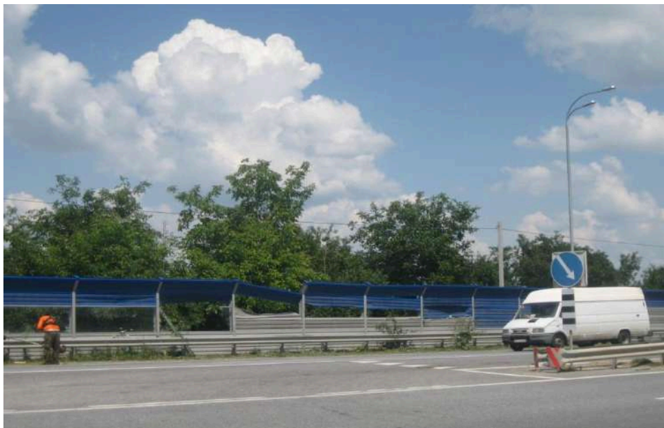
Рисунок 3.17 – Зруйнований довгомірними автотранспортними засобами ШЗЕ в місці розвороту автомобілів
