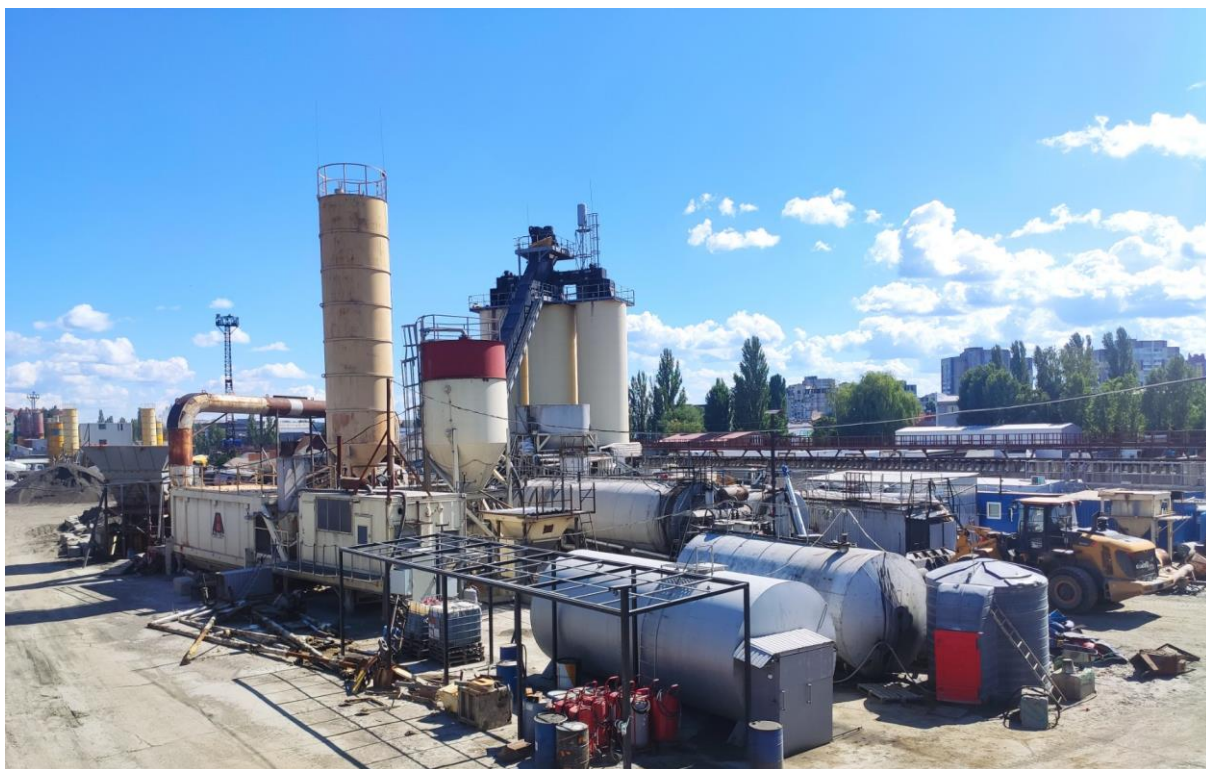
Рисунок 4.2 – Загальний вигляд АБЗ «ASTEC Portable 6' Double Barrel» (ТОВ «АБЗ1», м. Київ, вул. 9-го Травня, 49)
