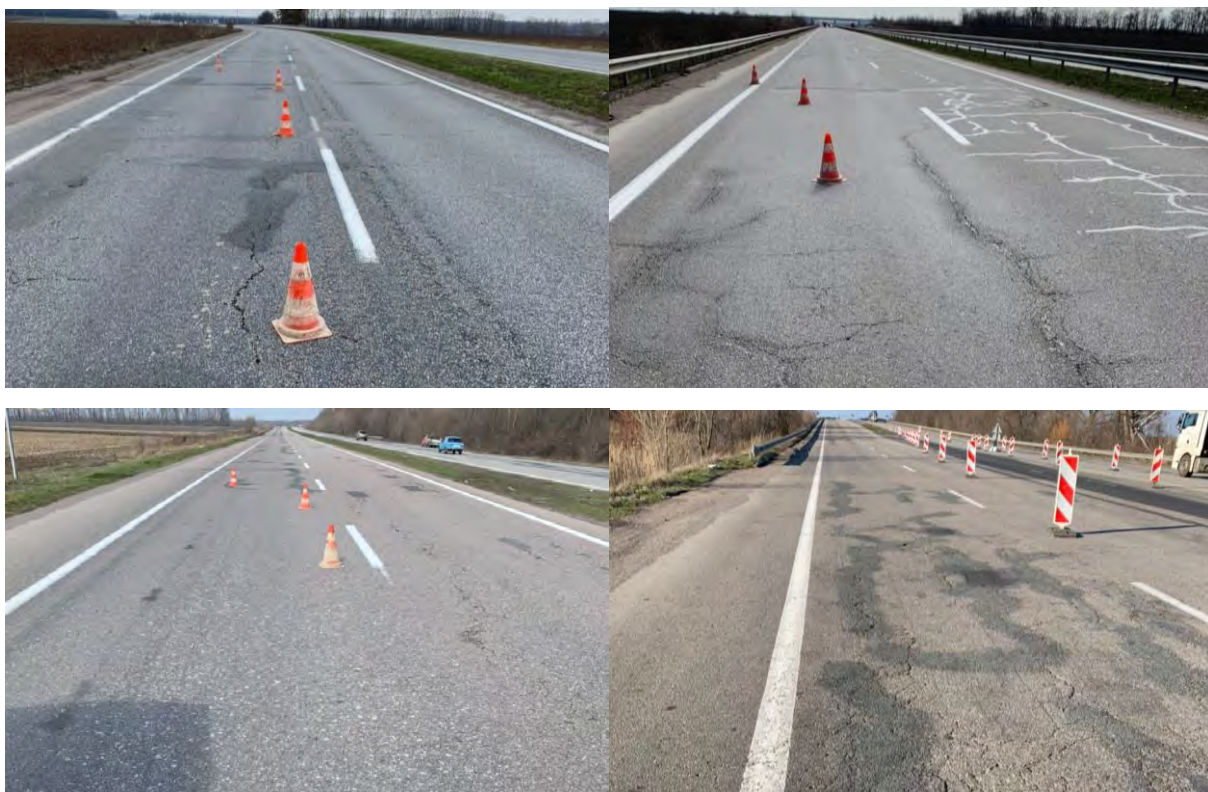
Рисунок Е.1 – Дефекти дорожнього покриття
