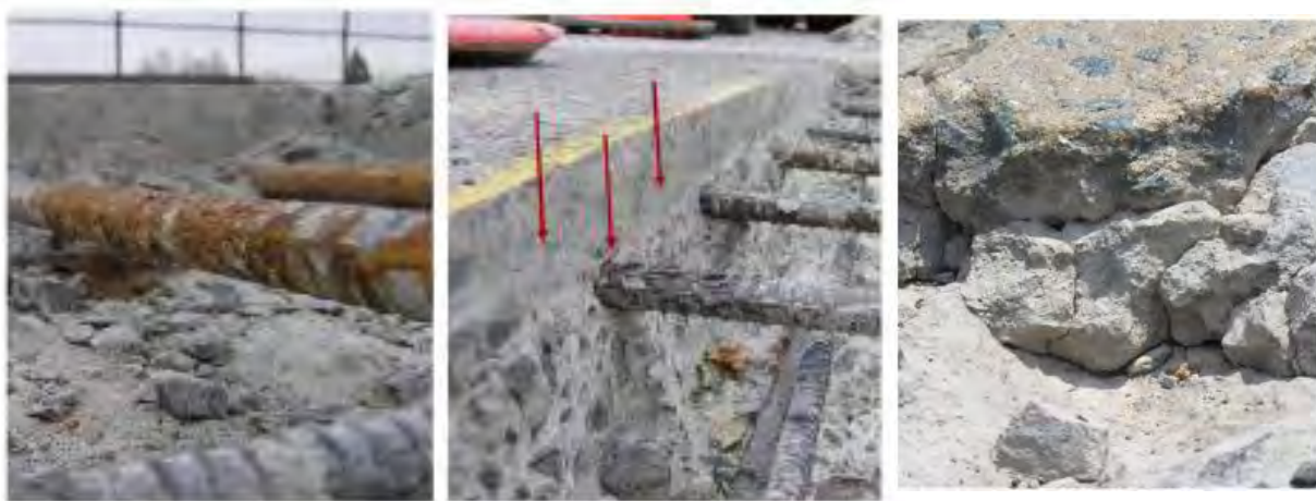
Рисунок 1.1 – Типові пошкодження металевої арматури в бетонній плиті мосту внаслідок корозії
