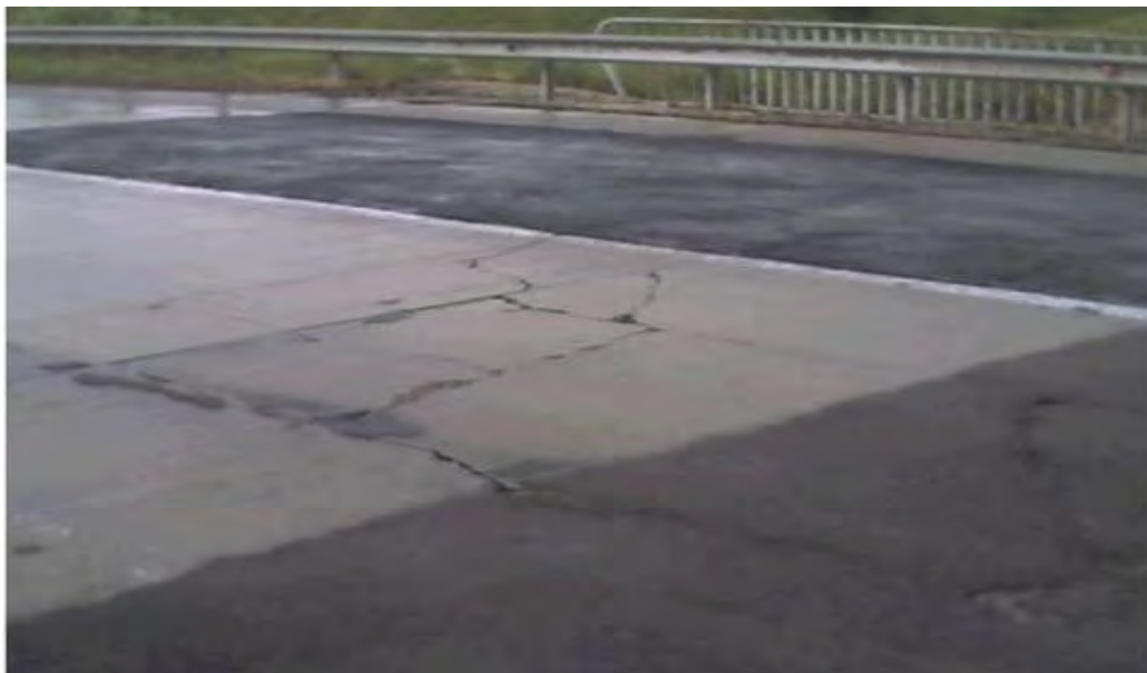
Рисунок 1.5 – Вигляд руйнування плит мостів внаслідок відшаровування захисного шару від металевої арматури
