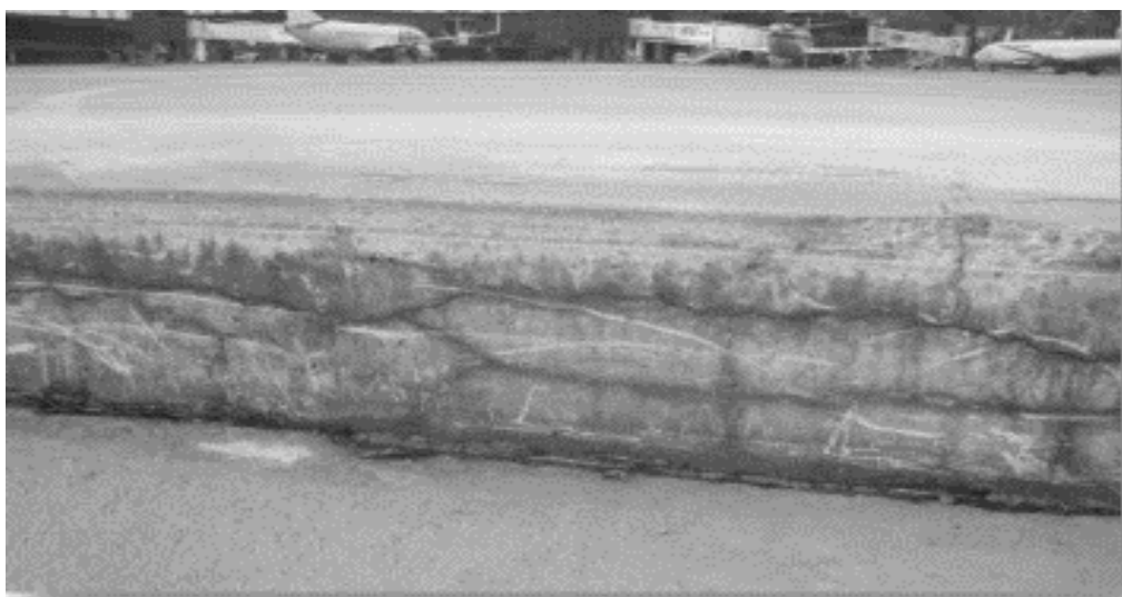
Рисунок 1.1 – Внутрішні тріщини в монолітній плиті
