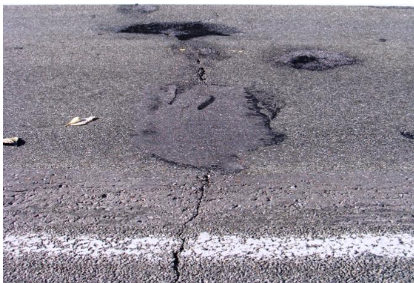
Рисунок 4.5 – Характерні дефекти старого покриття – поперечні тріщини
